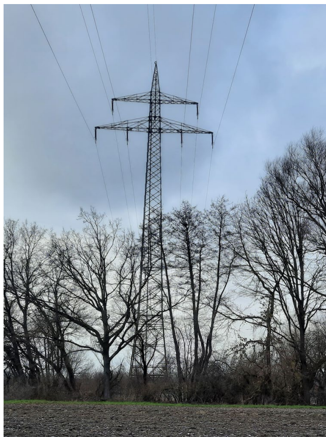
Abbildung 5: Foto - Mast Nr. E2
