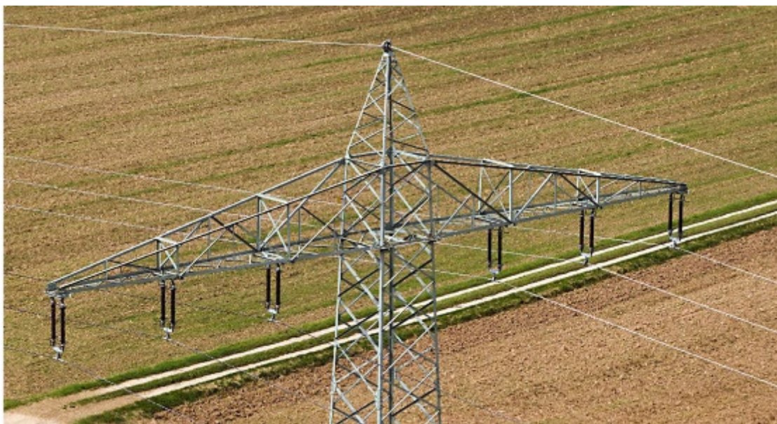
Abbildung 7: Bsp. Leiterseile an Traverse und Blitzschutzseil an der Mastspitze
