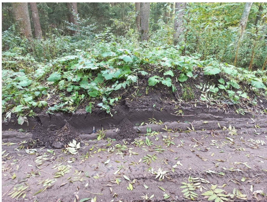
Foto 56: (F-C-56 in Anlage 1.9) Bereich Mastnummer 43 Blickrichtung SW
