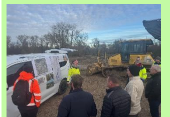
Vorstellung des Baufortschritts am neuen Donau-Seitenarm bei Irnsing durch das WWA Landshut (Fotos: W. Lorenz/RNB)
