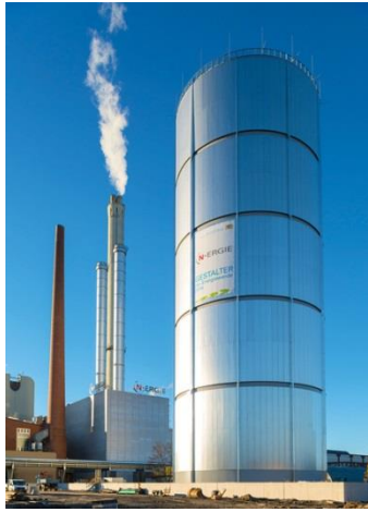
Wärmespeicher N-ERGIE Nürnberg Quelle: stadt+werk
